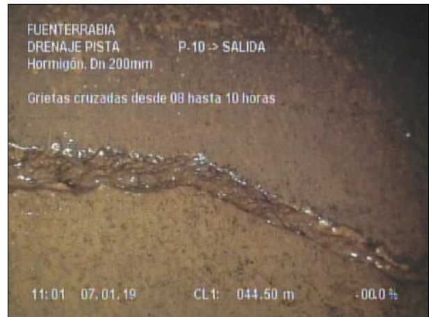
Fotografía: 52_6b 44,2m, Grietas cruzadas desde 08 hasta 10 horas
