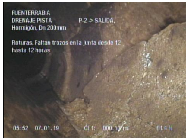
Fotografía: 6_2b 0,1m, Roturas. Faltan trozos en la junta desde 12 hasta 12 horas
