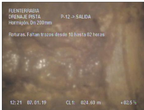
Fotografía: 68_4b 24,6m, Roturas. Faltan trozos desde 10 hasta 02 horas
