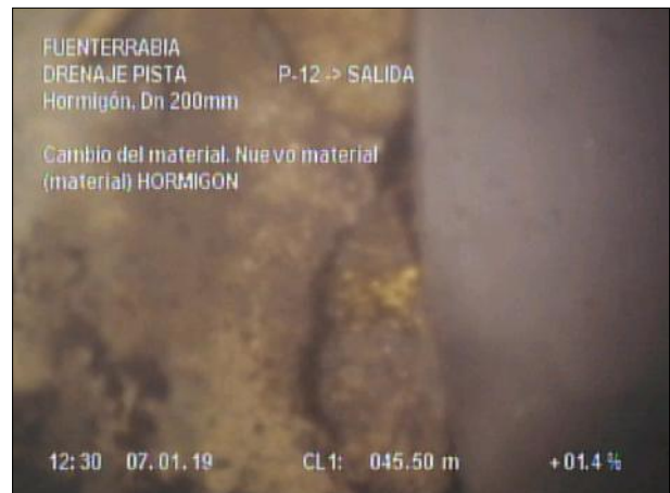
Fotografía: 73_9b 45,5m, Cambio del material. Nuevo material (material) HORMIGON
