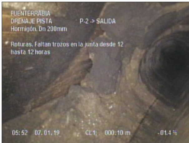
Fotografía: 6_2a 0,1m, Roturas. Faltan trozos en la junta desde 12 hasta 12 horas
