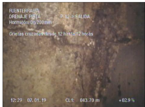
Fotografía: 71_7b 43m, Grietas cruzadas desde 12 hasta 12 horas
