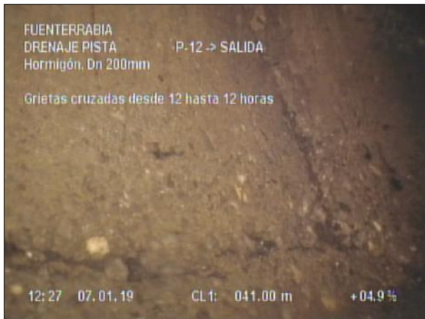
Fotografía: 70_6a 41m, Grietas cruzadas desde 12 hasta 12 horas
