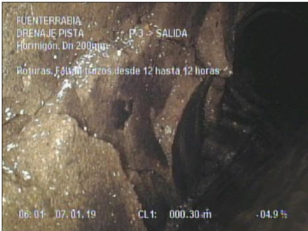
Fotografía: 9_2a 0,3m, Roturas. Faltan trozos desde 12 hasta 12 horas
