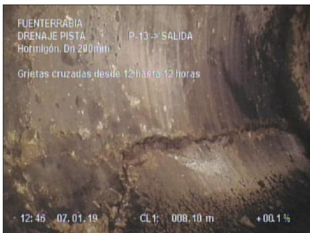
Fotografía: 77_3a 8,1m, Grietas cruzadas desde 12 hasta 12 horas
