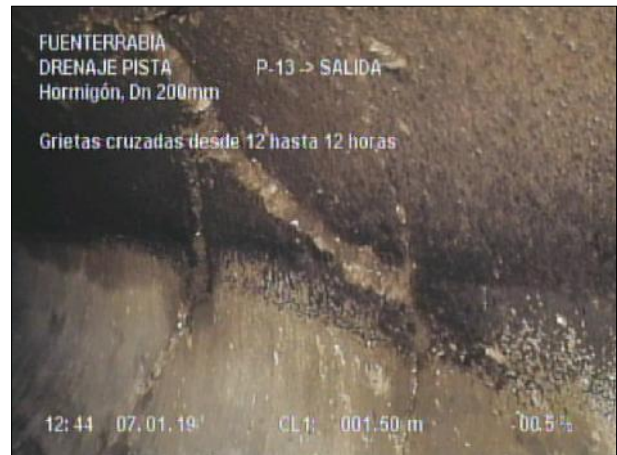
Fotografía: 76_2b 1,4m, Grietas cruzadas desde 12 hasta 12 horas
