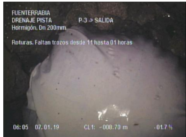
Fotografía: 11_4b 8,3m, Roturas. Faltan trozos desde 11 hasta 01 horas
