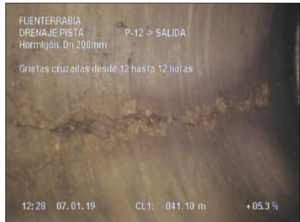
Fotografía: 70_6b 41m, Grietas cruzadas desde 12 hasta 12 horas
