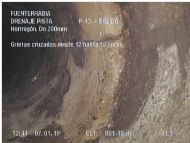
Fotografía: 76_2a 1,4m, Grietas cruzadas desde 12 hasta 12 horas
