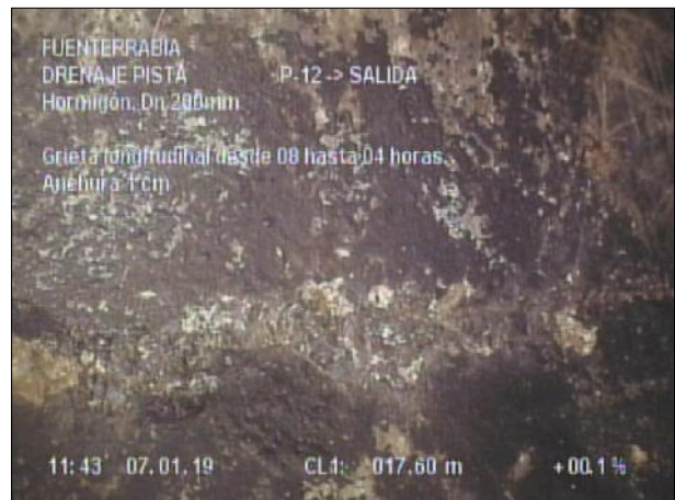
Fotografía: 62_5b 17m, Grieta longitudinal desde 08 hasta 04 horas. Anchura 1 cm
