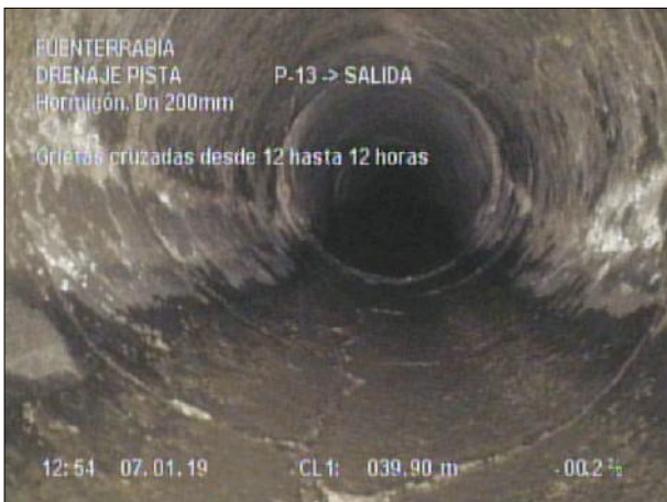
Fotografía: 79_5a 39,9m, Grietas cruzadas desde 12 hasta 12 horas
