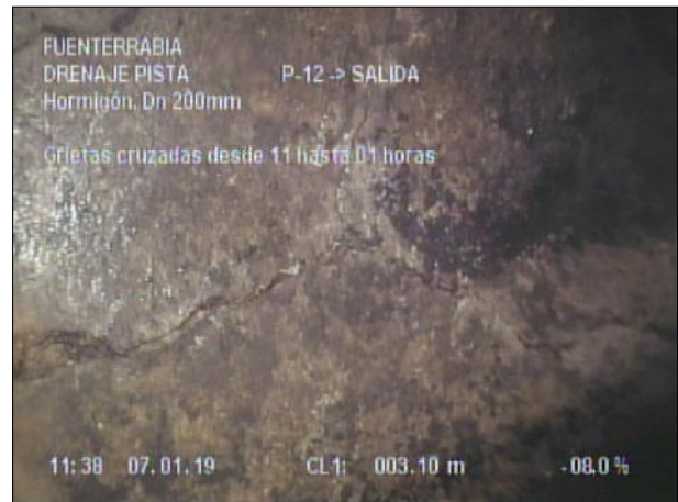
Fotografía: 59_2b 2,9m, Grietas cruzadas desde 11 hasta 01 horas
