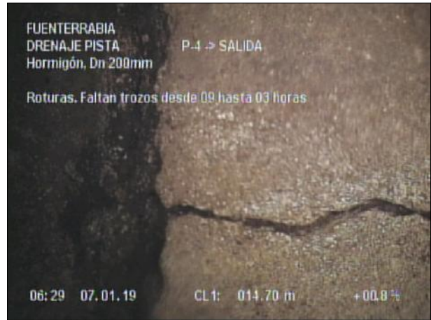
Fotografía: 18_4b 14,4m, Roturas. Faltan trozos desde 09 hasta 03 horas
