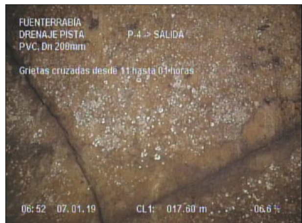
Fotografía: 28_8a 17,6m, Grietas cruzadas desde 11 hasta 01 horas
