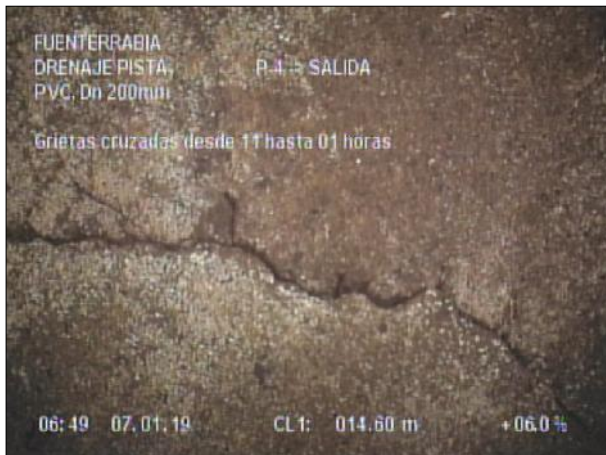
Fotografía: 26_6b 14,3m, Grietas cruzadas desde 11 hasta 01 horas
