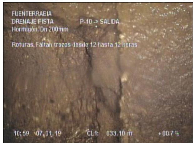
Fotografía: 51_5b 33,1m, Roturas. Faltan trozos desde 12 hasta 12 horas
