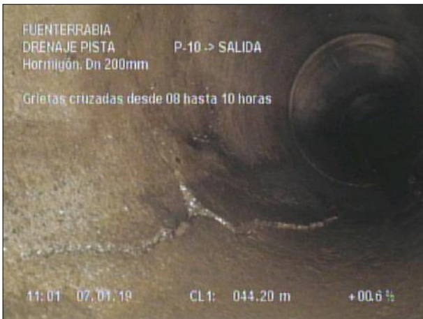
Fotografía: 52_6a 44,2m, Grietas cruzadas desde 08 hasta 10 horas
