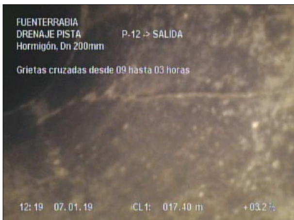
Fotografía: 67_3a 17,4m, Grietas cruzadas desde 09 hasta 03 horas
