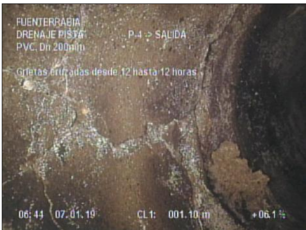
Fotografía: 23_3a 1,1m, Grietas cruzadas desde 12 hasta 12 horas
