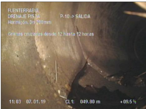
Fotografía: 53_7a 49,8m, Grietas cruzadas desde 12 hasta 12 horas
