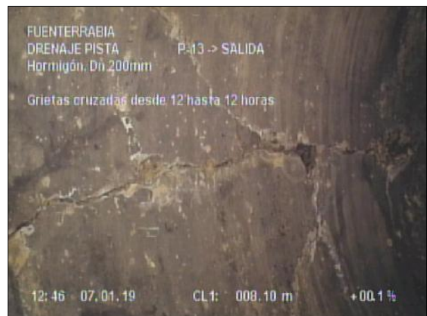
Fotografía: 77_3b 8,1m, Grietas cruzadas desde 12 hasta 12 horas
