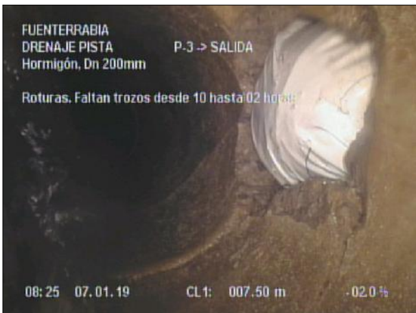
Fotografía: 36_3a 7,5m, Roturas. Faltan trozos desde 10 hasta 02 horas
