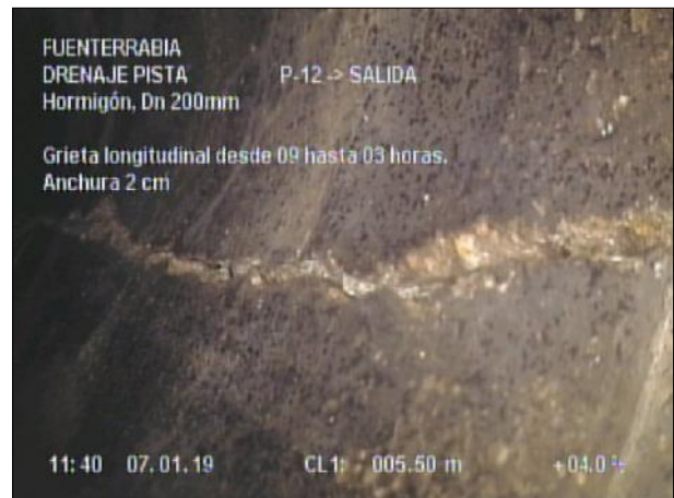
Fotografía: 60_3b 5,5m, Grieta longitudinal desde 09 hasta 03 horas. Anchura 2 cm
