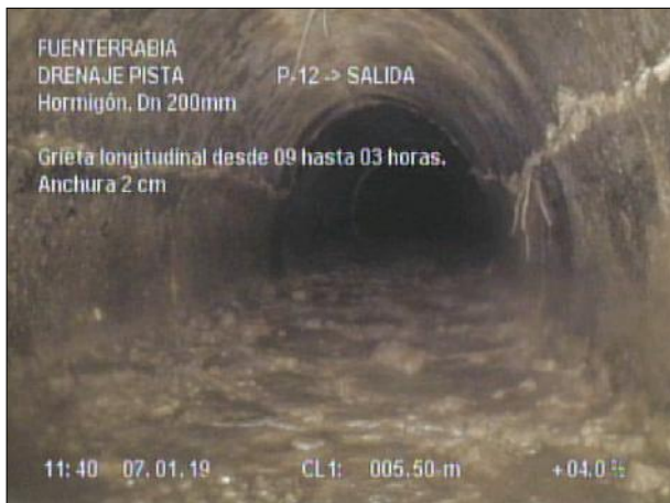
Fotografía: 60_3a 5,5m, Grieta longitudinal desde 09 hasta 03 horas. Anchura 2 cm
