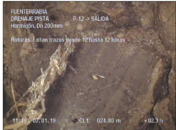
Fotografía: 63_6b 24,4m, Roturas. Faltan trozos desde 12 hasta 12 horas
