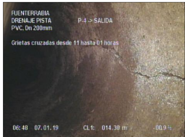
Fotografía: 26_6a 14,3m, Grietas cruzadas desde 11 hasta 01 horas
