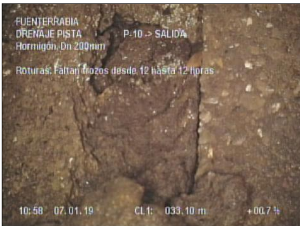
Fotografía: 51_5a 33,1m, Roturas. Faltan trozos desde 12 hasta 12 horas
