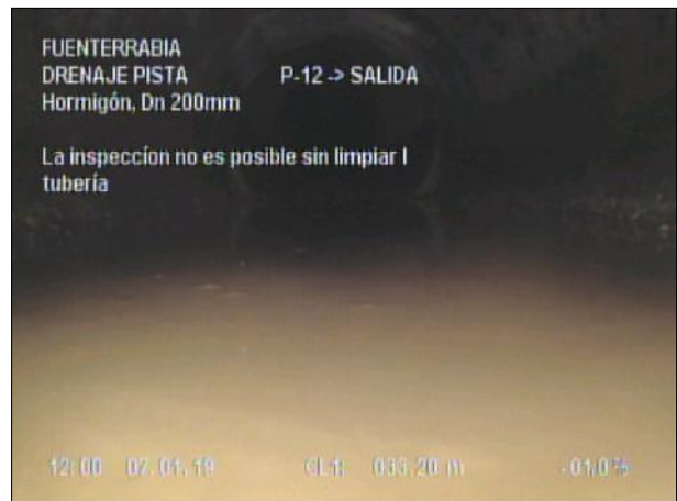
Fotografía: 64_7b 33,2m, La inspección no es posible sin limpiar l tubería
