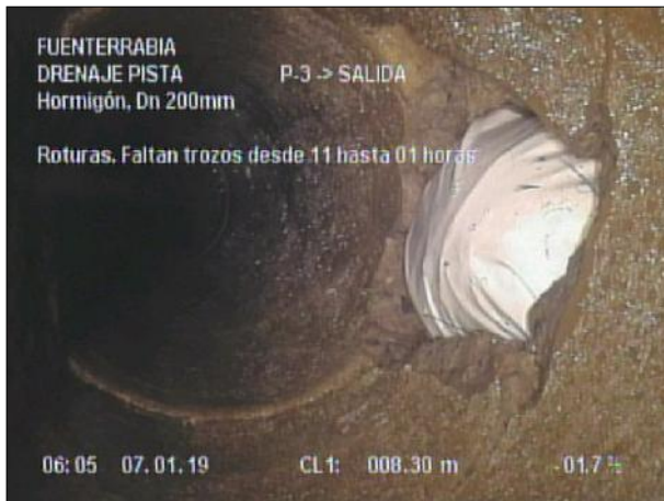
Fotografía: 11_4a 8,3m, Roturas. Faltan trozos desde 11 hasta 01 horas
