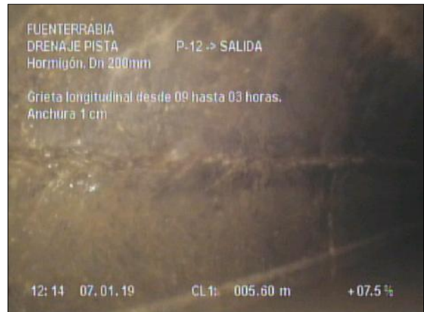
Fotografía: 66_2b 5,1m, Grieta longitudinal desde 09 hasta 03 horas. Anchura 1 cm
