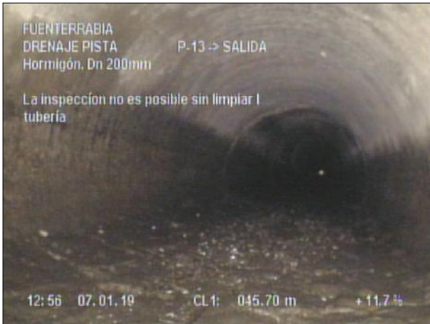
Fotografía: 80_6a 45,7m, La inspección no es posible sin limpiar l tubería
