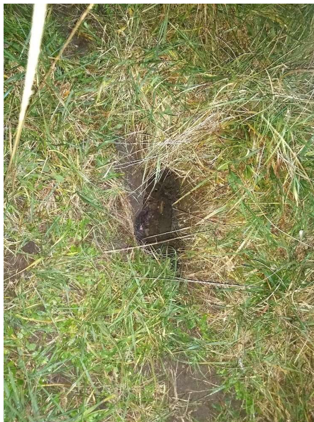
Imagen 3 Rotura de colector visible desde el exterior
