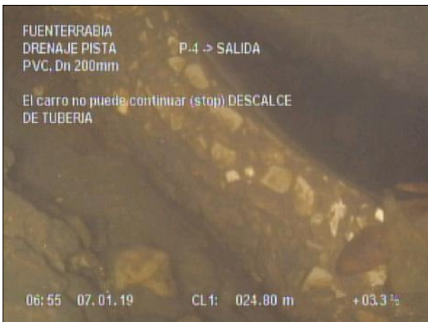
Fotografía: 29_9b 24,8m, El carro no puede continuar (stop) DESCALCE DE TUBERIA
