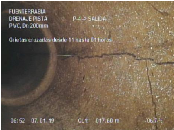
Fotografía: 28_8b 17,6m, Grietas cruzadas desde 11 hasta 01 horas
