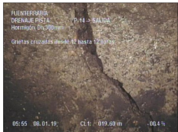
Fotografía: 83_3b 19,6m, Grietas cruzadas desde 12 hasta 12 horas
