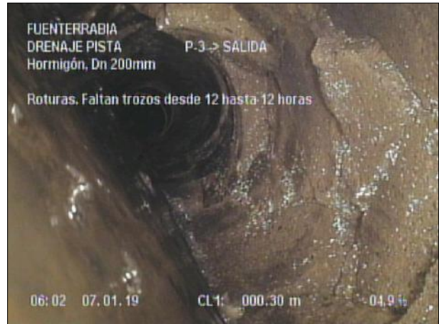
Fotografía: 9_2b 0,3m, Roturas. Faltan trozos desde 12 hasta 12 horas
