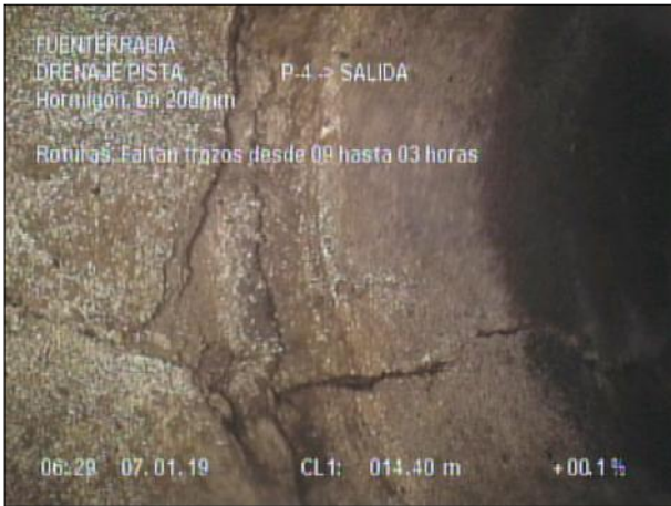
Fotografía: 18_4a 14,4m, Roturas. Faltan trozos desde 09 hasta 03 horas
