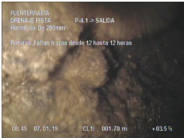
Fotografía: 39_2a 1,7m, Roturas. Faltan trozos desde 12 hasta 12 horas
