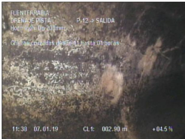
Fotografía: 59_2a 2,9m, Grietas cruzadas desde 11 hasta 01 horas
