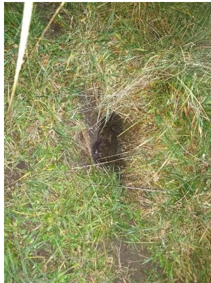
Imagen 16. Rotura de colector en franja. Fuente: Inspección de colectores.
