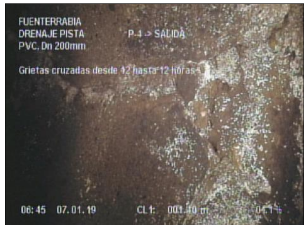
Fotografía: 23_3b 1,1m, Grietas cruzadas desde 12 hasta 12 horas
