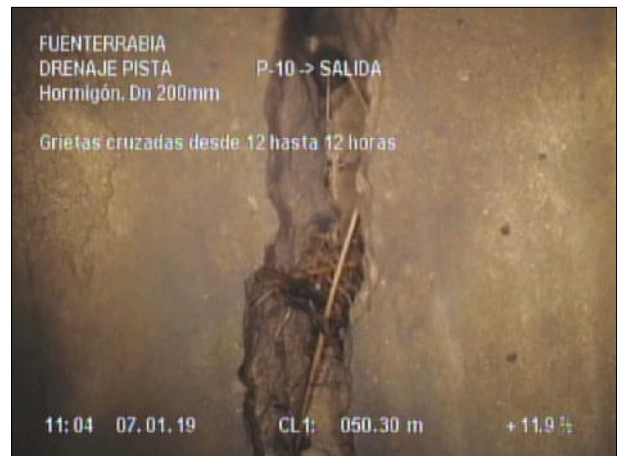
Fotografía: 53_7b 49,8m, Grietas cruzadas desde 12 hasta 12 horas
