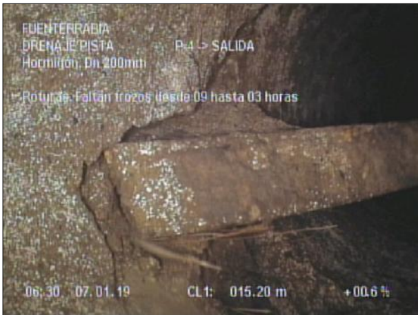
Fotografía: 19_5a 15,2m, Roturas. Faltan trozos desde 09 hasta 03 horas
