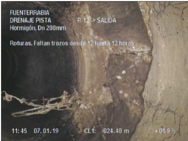
Fotografía: 63_6a 24,4m, Roturas. Faltan trozos desde 12 hasta 12 horas
