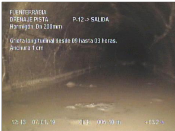
Fotografía: 66_2a 5,1m, Grieta longitudinal desde 09 hasta 03 horas. Anchura 1 cm
