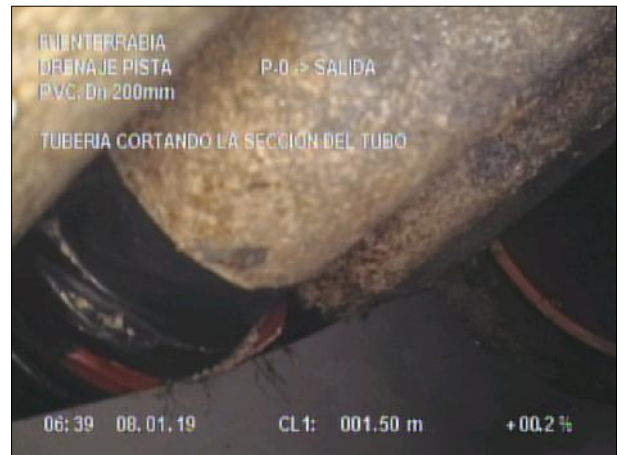
Fotografía: 90_2b 1,4m, TUBERÍA CORTANDO LA SECCION DEL TUBO
