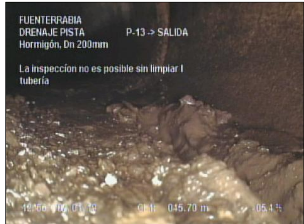
Fotografía: 80_6b 45,7m, La inspección no es posible sin limpiar l tubería
