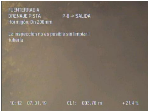
Fotografía: 44_2a 3,7m, La inspección no es posible sin limpiar l tubería
