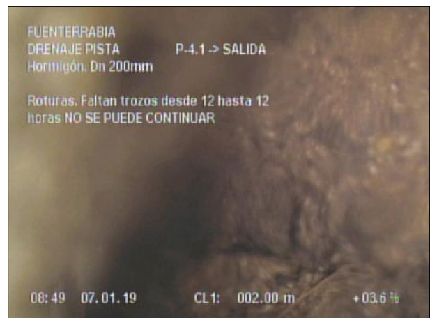
Fotografía: 40_3b 2m, Roturas. Faltan trozos desde 12 hasta 12 horas NO SE PUEDE CONTINUAR
