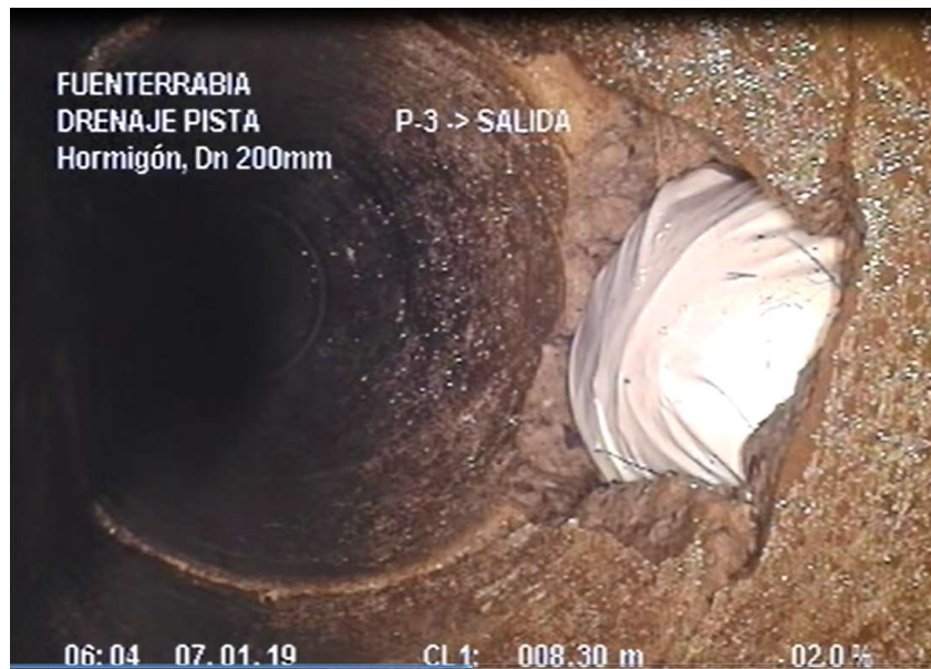
Imagen 2 Rotura de colector P-3.
