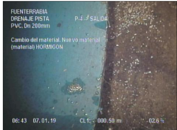
Fotografía: 22_2b 0,3m, Cambio del material. Nuevo material (material) HORMIGON
