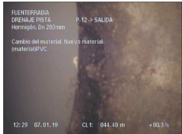
Fotografía: 72_8b 44,4m, Cambio del material. Nuevo material (material)PVC
