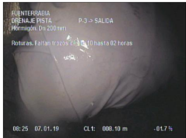
Fotografía: 36_3b 7,5m, Roturas. Faltan trozos desde 10 hasta 02 horas
