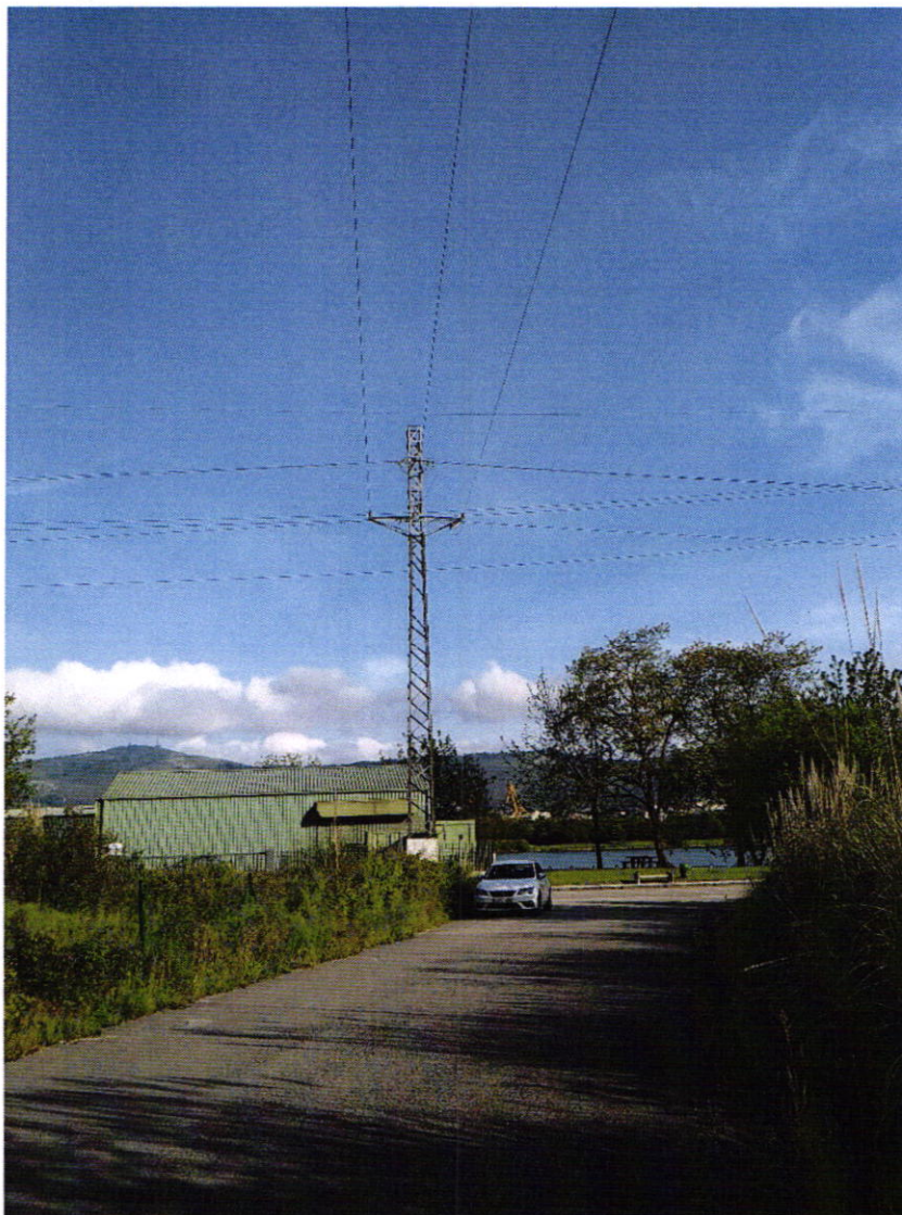
Foto 3: Apoyo Metálico P-6 en zona de Dominio Público Marítimo-Terrestre.
