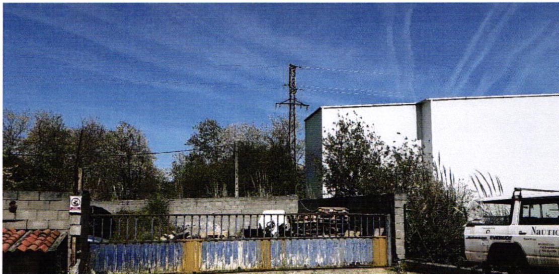
Foto 1: Apoyo metálico P-4 en zona de Dominio Público Marítimo-Terrestre.
