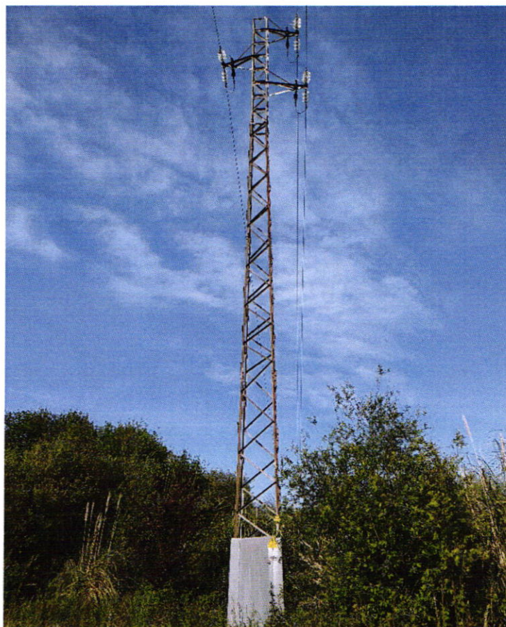
Foto 2: Apoyo metálico P-5 en zona de Dominio Público Marítimo-Terrestre.
