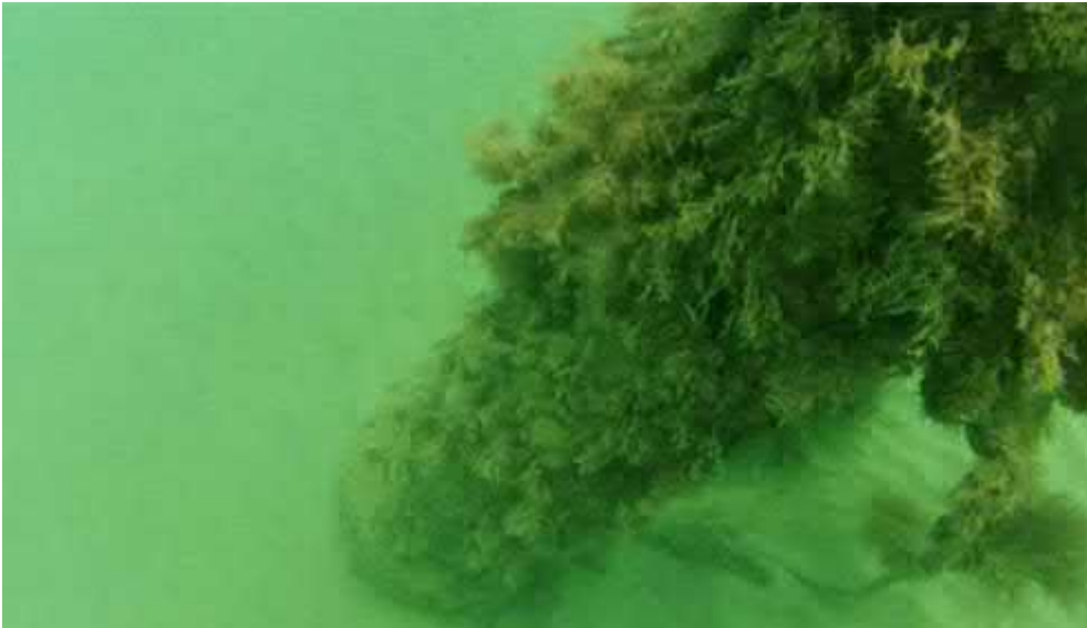
Vista cenital de la conducción de 800 mm, con la derivación que emerge de la arena y el difusor (cubierto de biocenosis).
