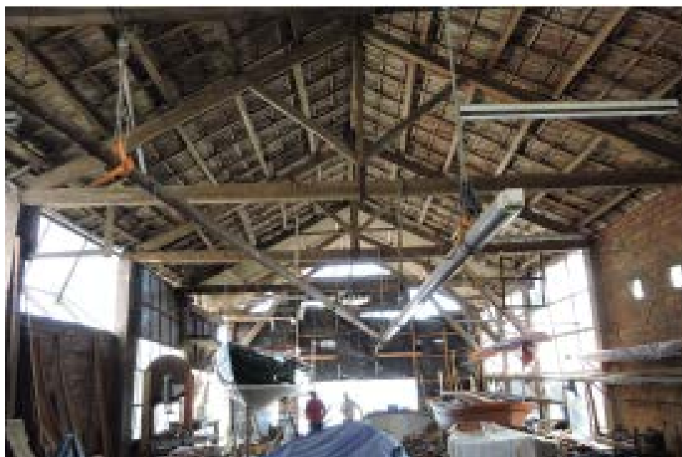
Imagen general_ Interior Calragho previa incendio, año 2015:
