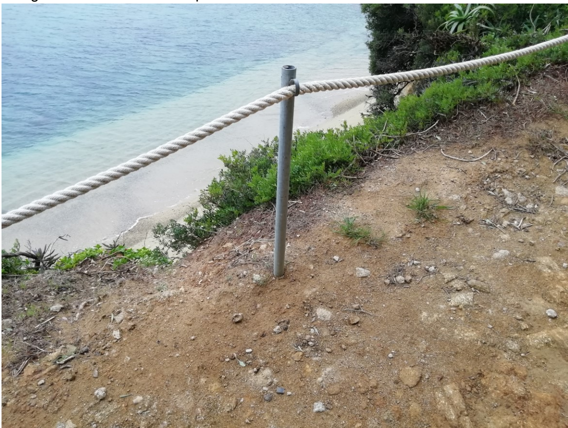
Fotografia 8. Barana tipus existent puntalment
