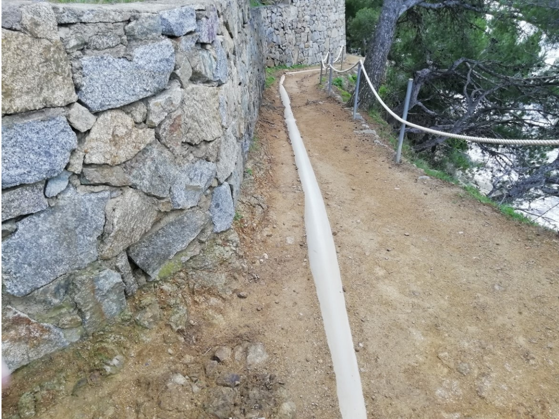
Fotografia 11. Tram camí amb presència de xarxa de clavegueram
