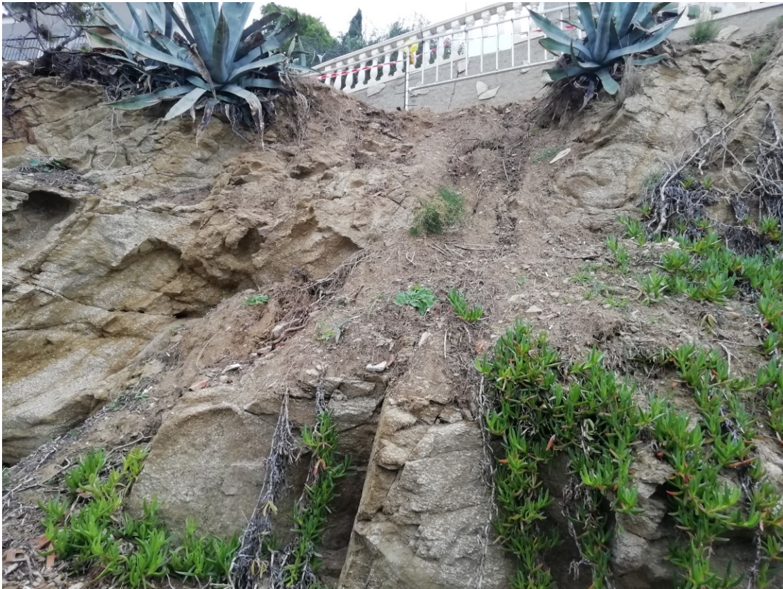
Fotografia 5. Talús amb necessitats d'estabilització
