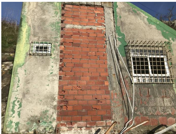
Ilustración 7: Vista cara Oeste de la instalación
