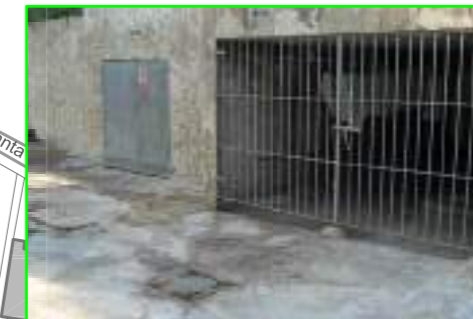
Foto 2 - Instalacion de gas
