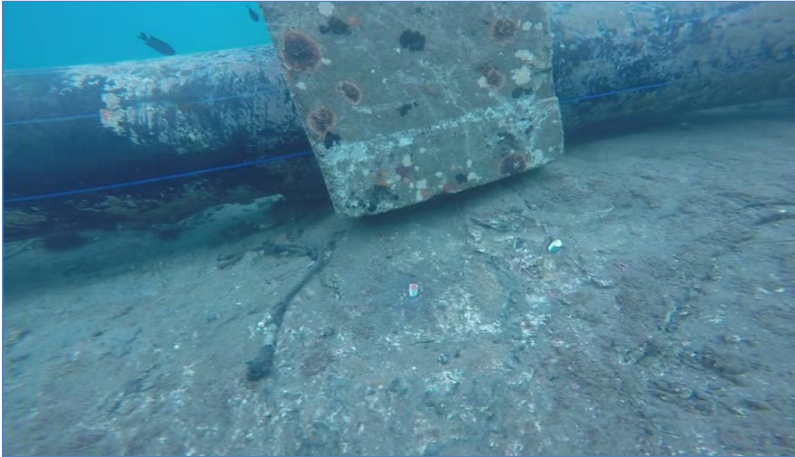
Figura 11. Rotura de las cabezas de los anclajes.
