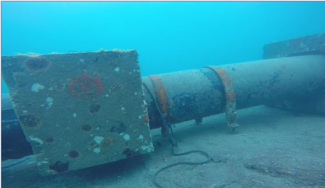
Figura 7. Zunchos y anclajes arrancados.
