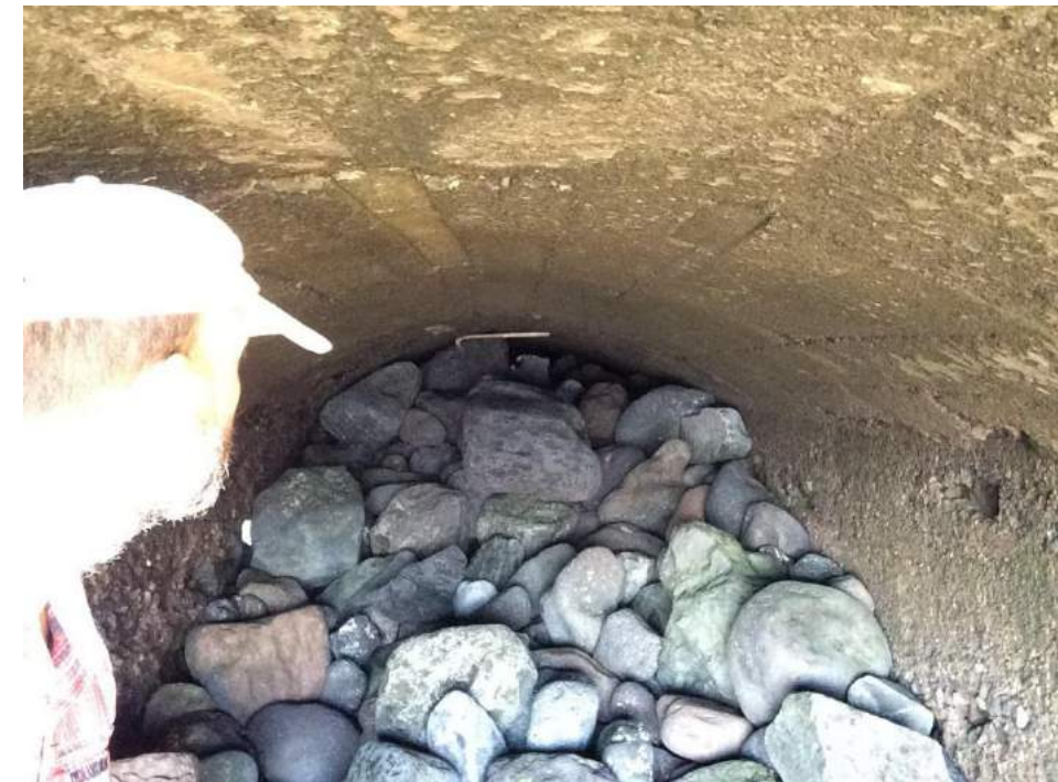
Aspecto del interior de la obra de fábrica, totalmente obturada por el arrastre del oleaje.
