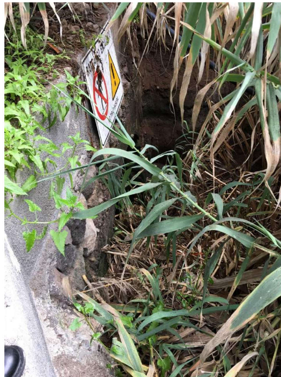
Boca de entrada a la obra de desagüe del barranco de Las Furnias, prácticamente inapreciable debido a la presencia de abundante vegetación.
