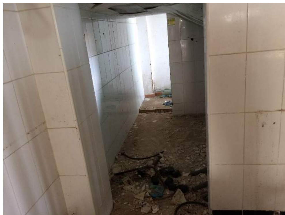
Detalle del estado de la planta inferior.
