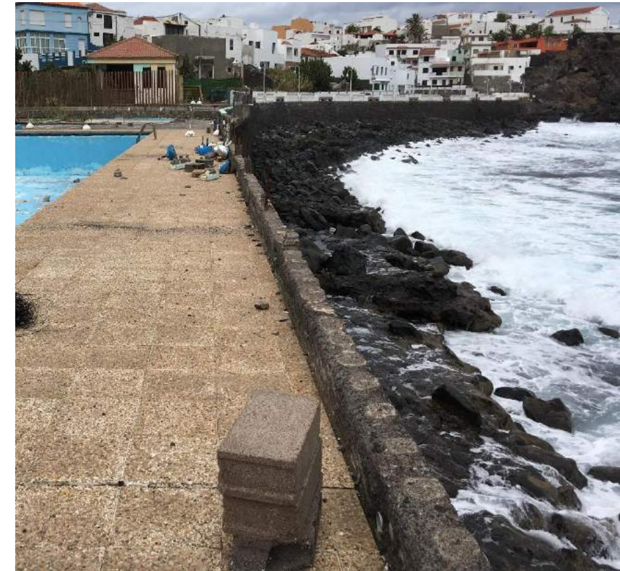
Cerramiento exterior del frente marítimo inexistente (alto nivel de peligrosidad).
