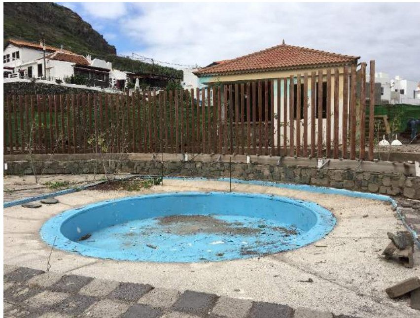
Detalle de la piscina auxiliar y de kiosco detrás (deterioro evidente).
