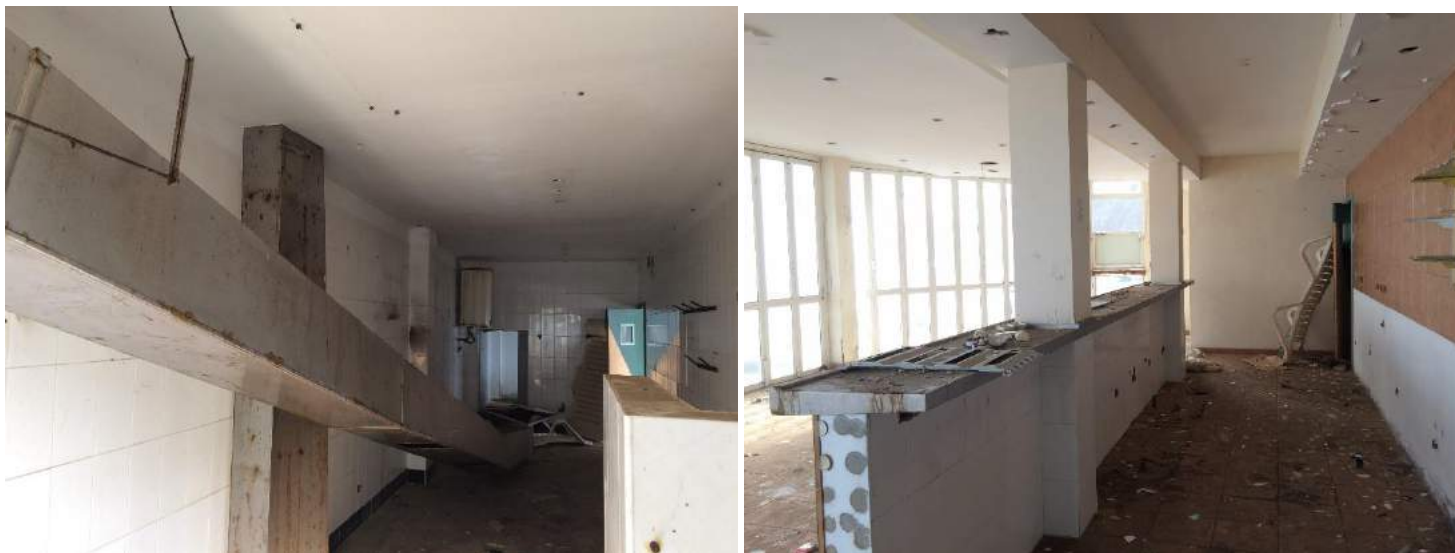
Antigua zona de cocina y de restaurante en estado de ruina.
