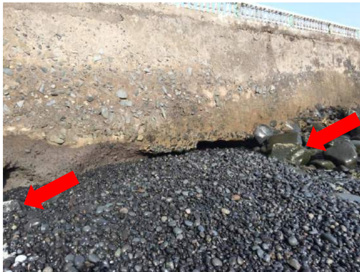
Figura 7. Detalle del socavamiento del muro perimetral.
