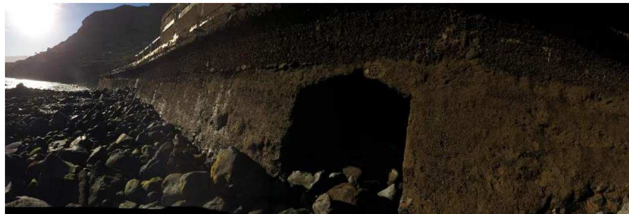
Localización de la boca de salida de la obra de fábrica en el muro perimetral de las piscinas.
