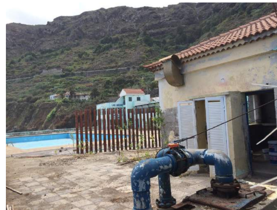
Conducciones de llenado y explotación de las piscinas Detrás fachada al mar del kiosco.
