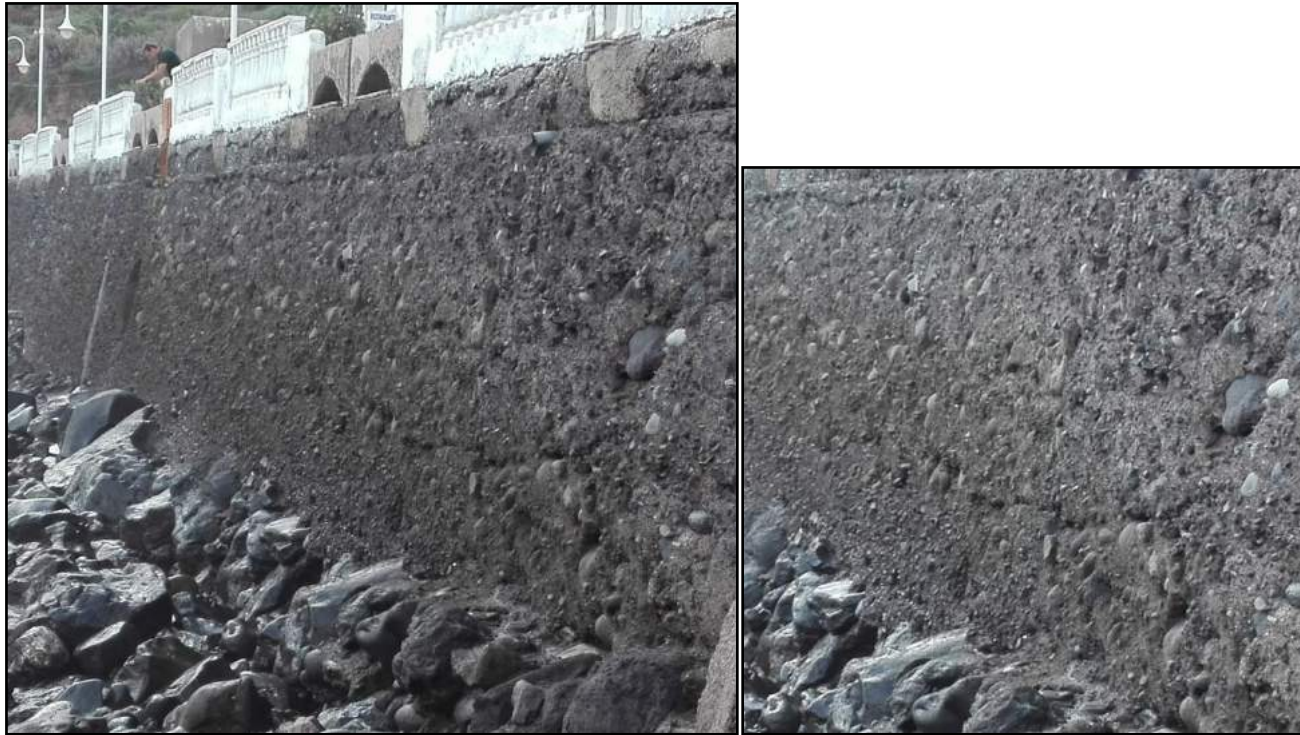
Figura 1. Muro de protección del Paseo de Las Aguas. Estado actual (detalle).
