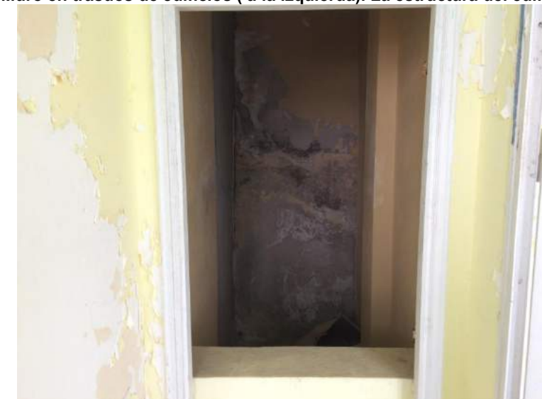
Figura 6. Muro en trasdós de edificios (al fondo). "Afloramiento" en antiguo montacargas.
