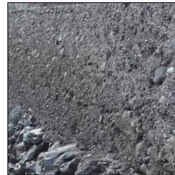
Figura 30. Muro de protección del Paseo de Las Aguas. Estado actual (detalle).
