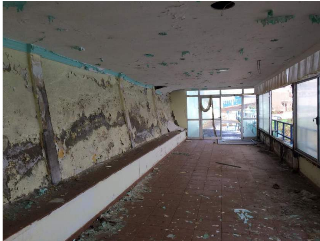
Detalle interior del edificio en la zona de acceso principal. Se puede observar el paramento revestido colindante con el cantil natural (deterioro manifiesto).
