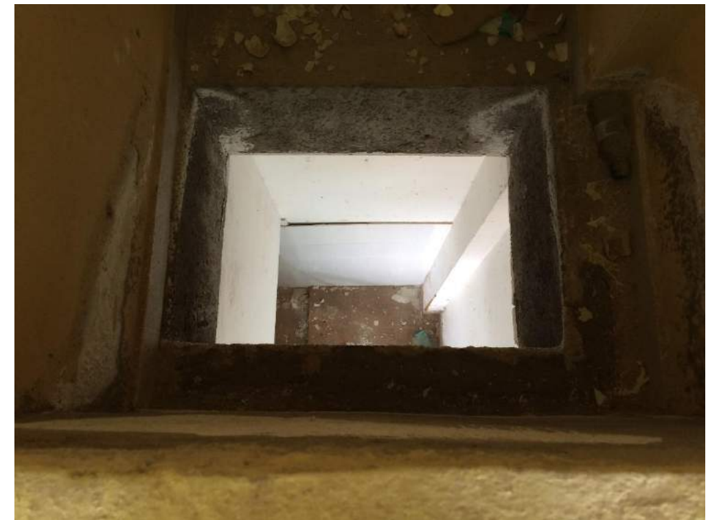
Detalle hueco montacarga. En la primera planta no se puede observar la continuidad del tratamiento con hormigón del cantil.
