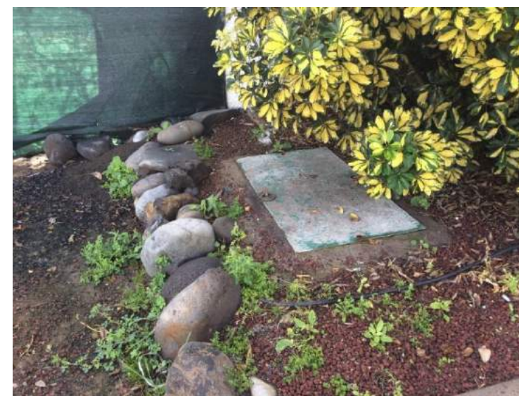
Detalle de la arqueta de acceso a la fosa séptica.
