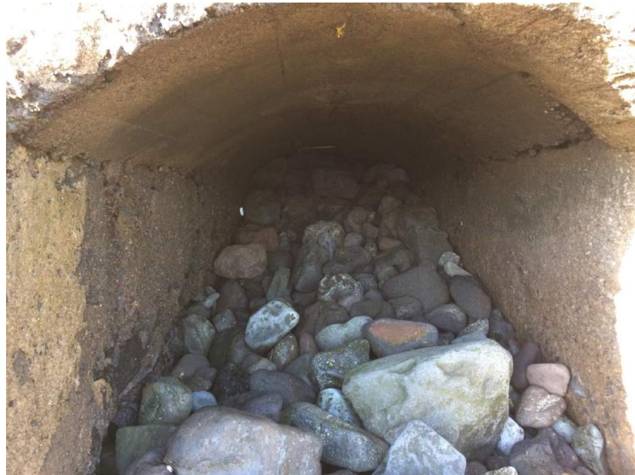
Figura 3. Detalle del estado de obturación actual de la OF.1.
