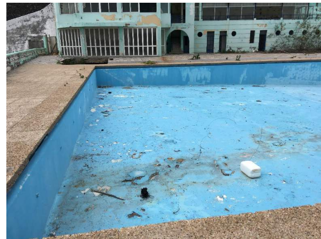
Detalle de la piscina principal (deterioro evidente).
