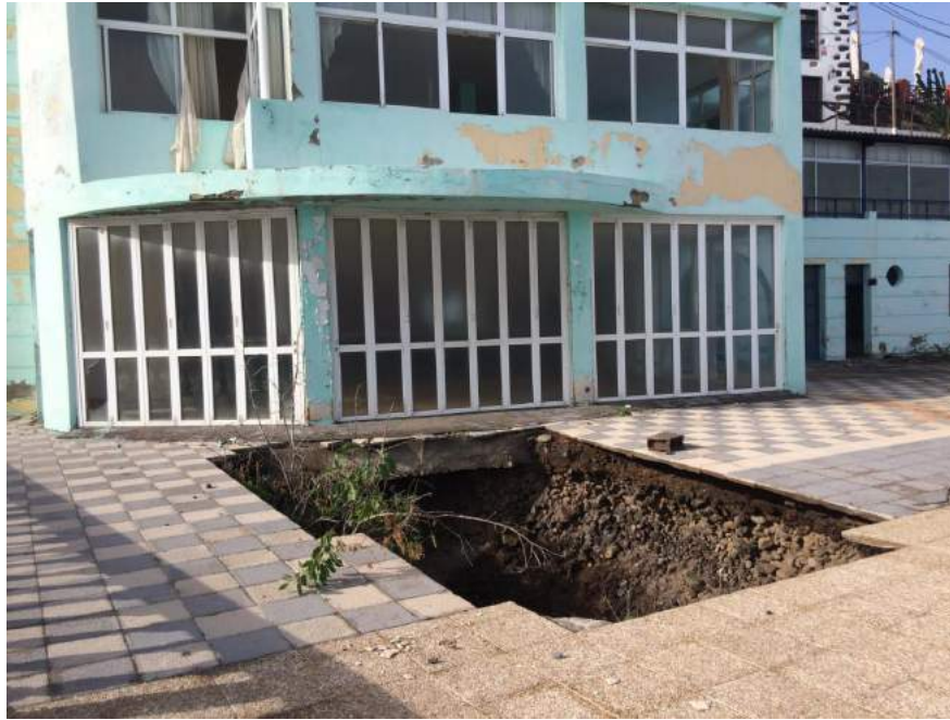
Figura 6. Socavón en el interior del recinto de las piscinas (socavamiento del muro perimetral y lavado del material de relleno de la plataforma).
