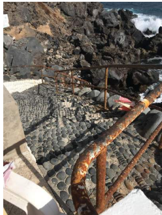
Figura 10. Acceso Oeste al mar. Detalle del estado actual.
