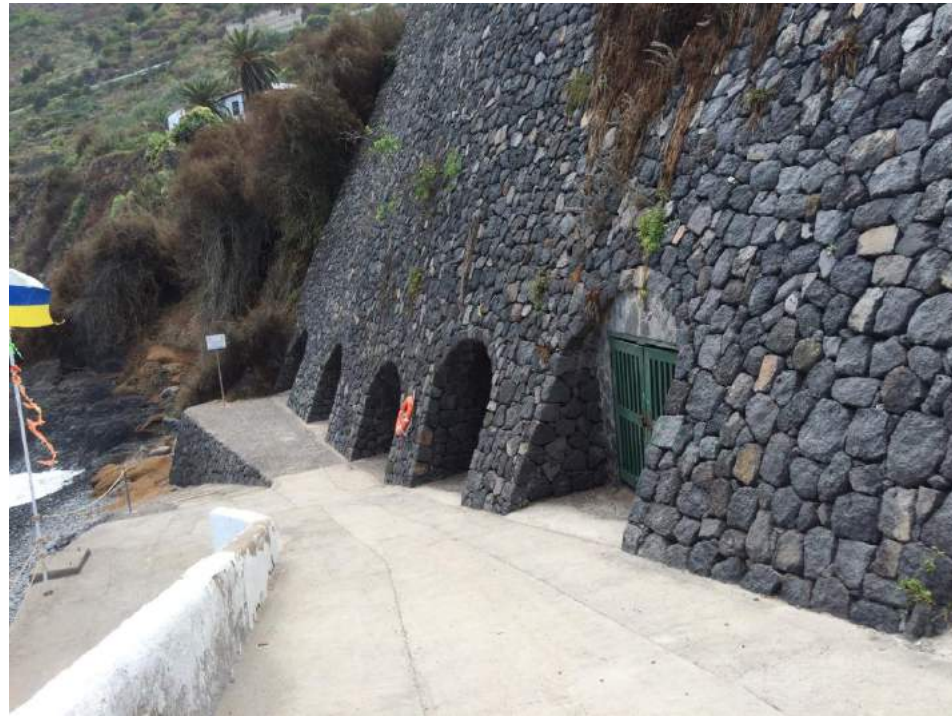
Figura 3. Acantilado del extremo oriental de la actuación, estabilizado mediante un muro de contención.
