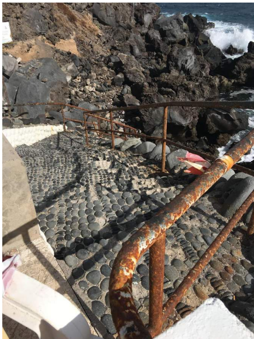
Figura 2. Estado del acceso norte al mar, clausurado y expuesto a los desprendimientos de la ladera colindante.
