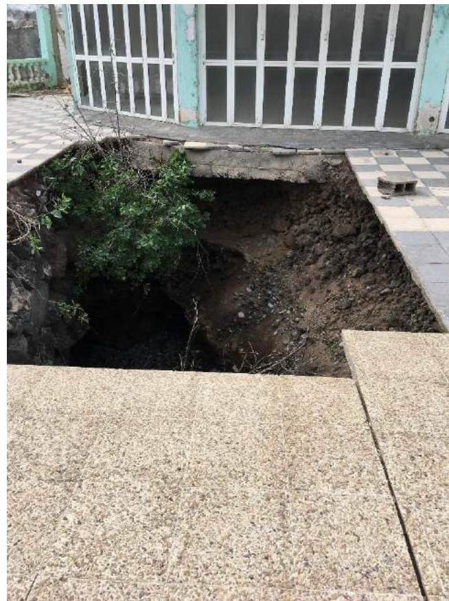
Socavón profundo en la zona aledaña a la piscina principal, en progresivo avance por lavado del relleno.
