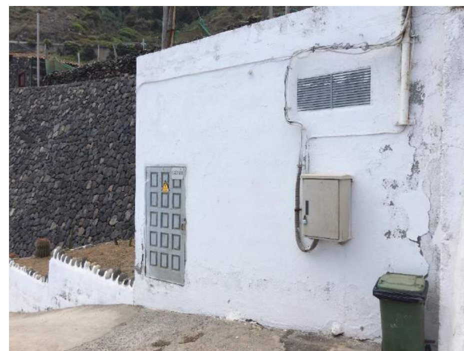
Transformador en la rampa de bajada.
