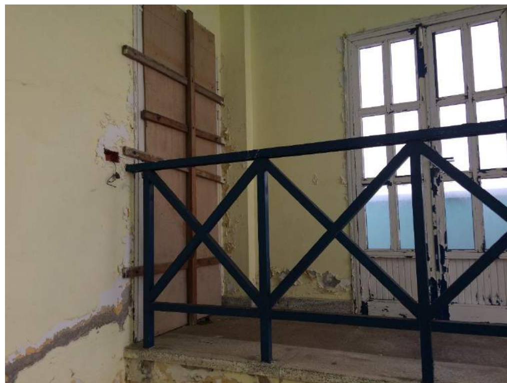
Acceso condonado a la terraza del nivel superior.
