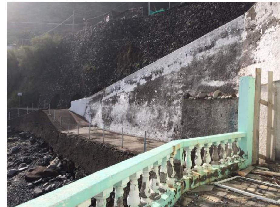
Figura 12. Acceso Este al mar. Detalle del estado actual. En este punto del vallado se ha abierto un acceso a las instalaciones ruinosas.
