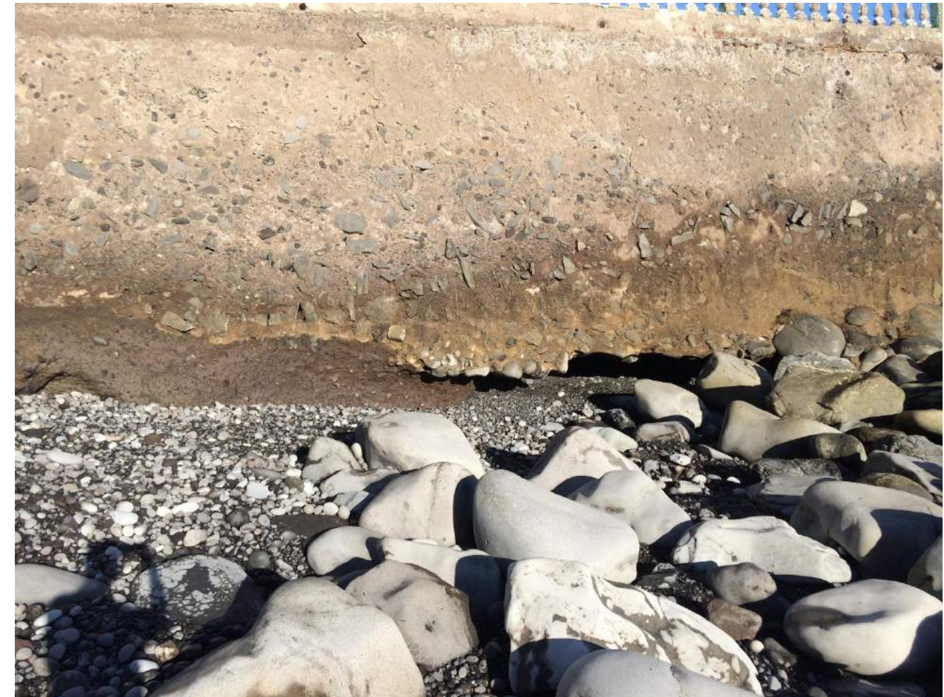
Detalle del socavamiento del muro perimetral de las piscinas.
