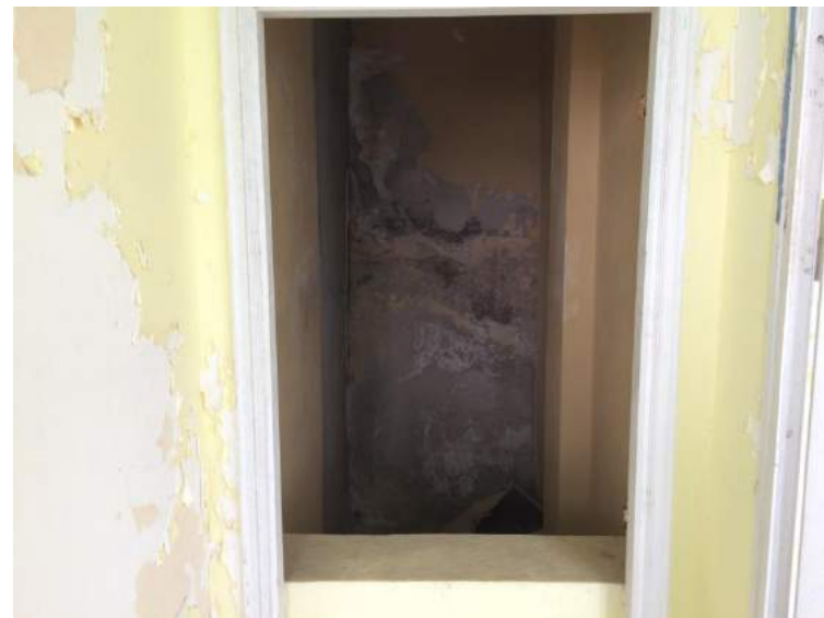
Figura 29. Muro en trasdós de edificios (al fondo). "Afloramiento" en antiguo montacargas.
