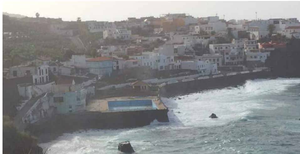
Figura 49. Vista general de la zona de obras. En primer término, las piscinas fuera de servicio a demoler.
